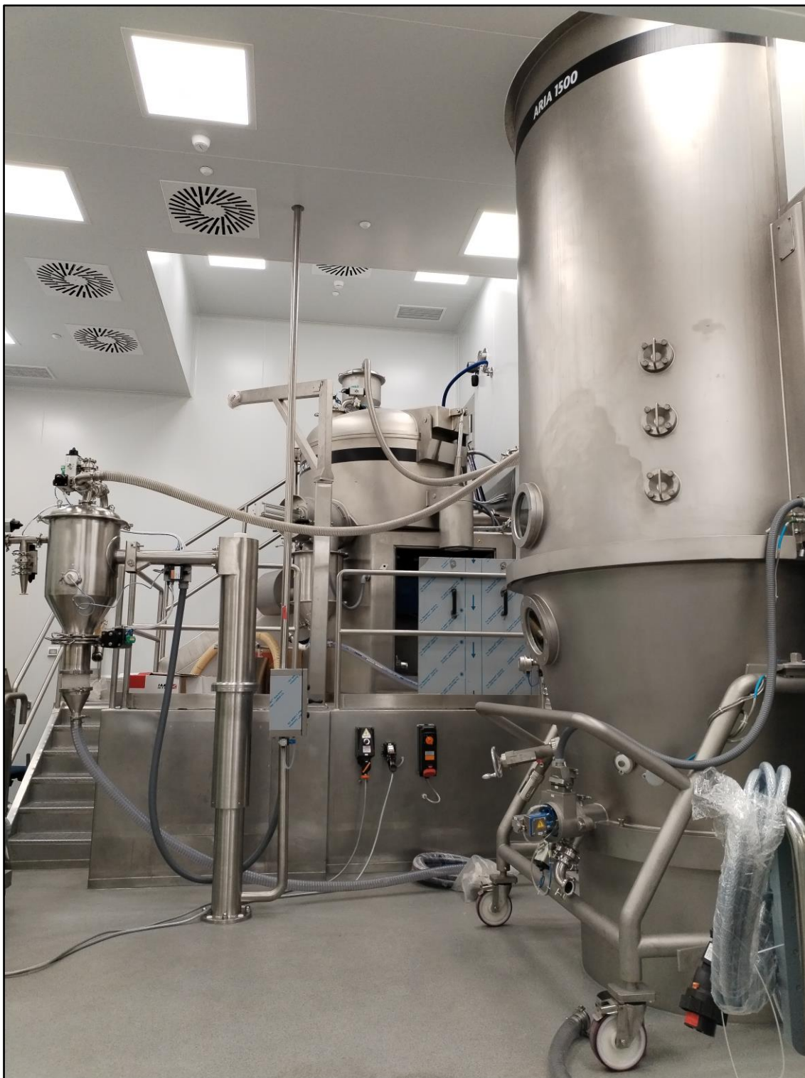
Aria y Rotomix 1500 ubicados en Sala Granulación 1
